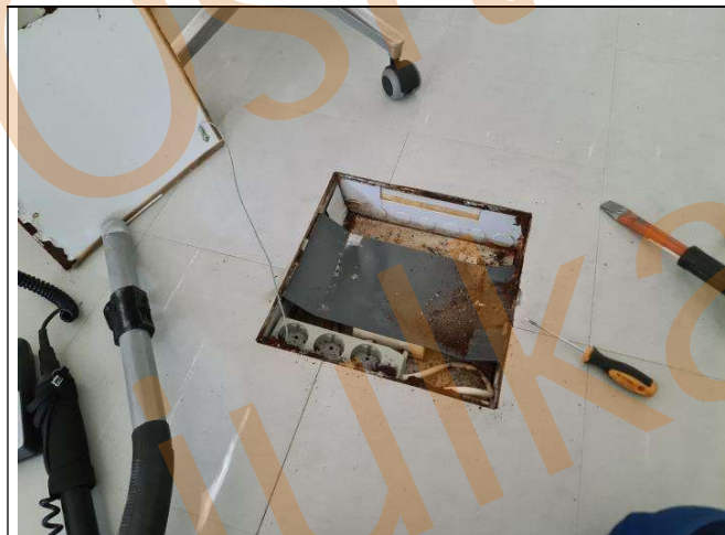
Kuva 5. Luokkatilan 113 sähkölattialuukun sisältä tullut haju oli tunkkainen, kun luukku irrotettiin. Luukut ovat kuitenkin olleet tiiviisti kiinni vahattuna, eikä luukun takana olevaa likaista ilmaa ole merkittävästi luukun takaa päässyt sisäilmaan.
