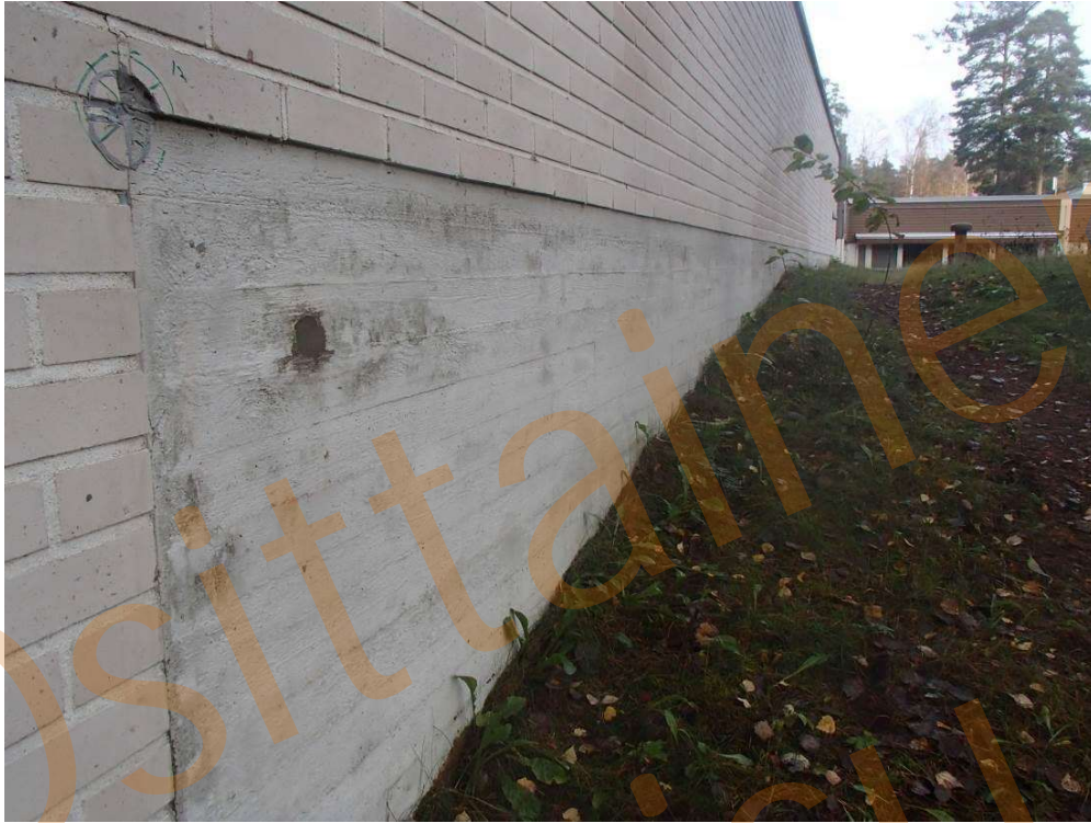
Kuva 126. Rakennuksen ympärillä olevat maat kaatavat paikoin rakennusta kohden.
