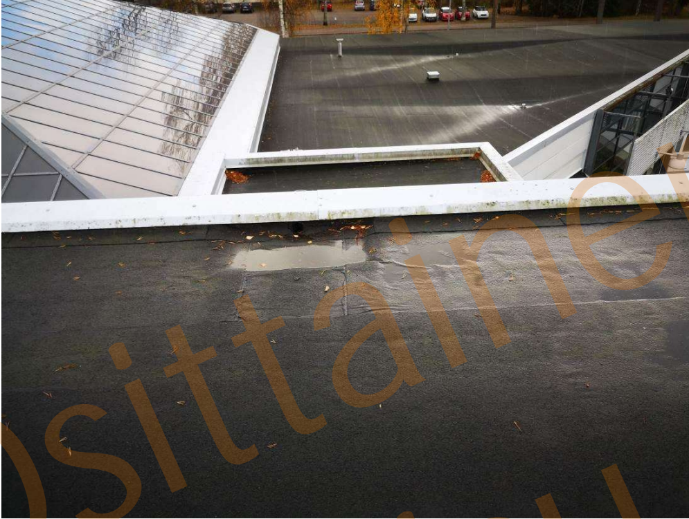
Kuva 164. Juhlasalin kattopintojen sadevedenpoistoaukkojen ympärillä havaittiin lammikointumista.
