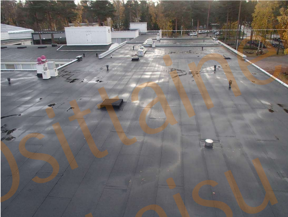
Kuva 170. Vesikaton lammikoitumista 1977 rakennetun laajennusosan kattopinnoilla.
