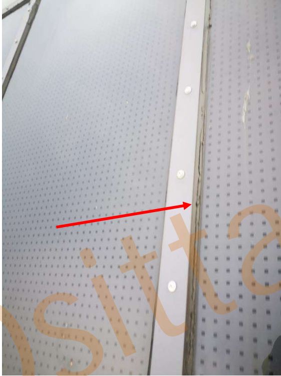
Kuva 176. Lasikaton tiivistyksen vaurioita.
