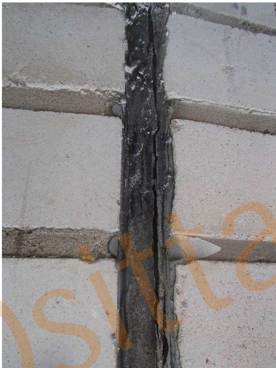
Kuva 120. Rakennuksen elastiset saumamassat ovat vaurioituneet.
