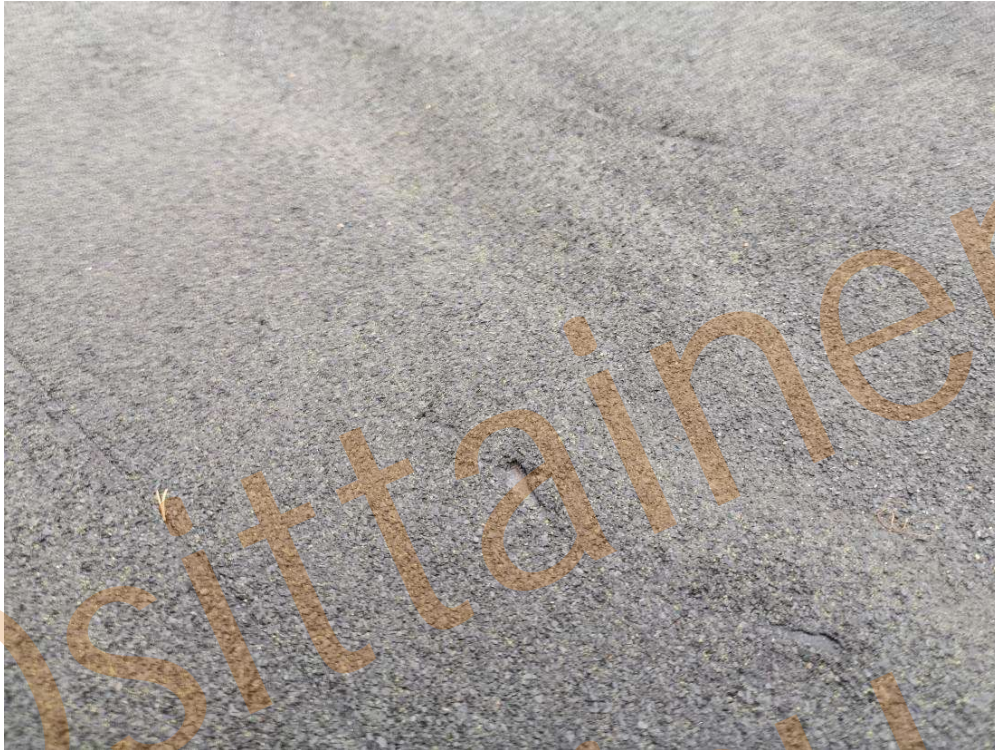
Kuva 166. Juhlasalin bitumikermissä havaittiin vaurioita.
