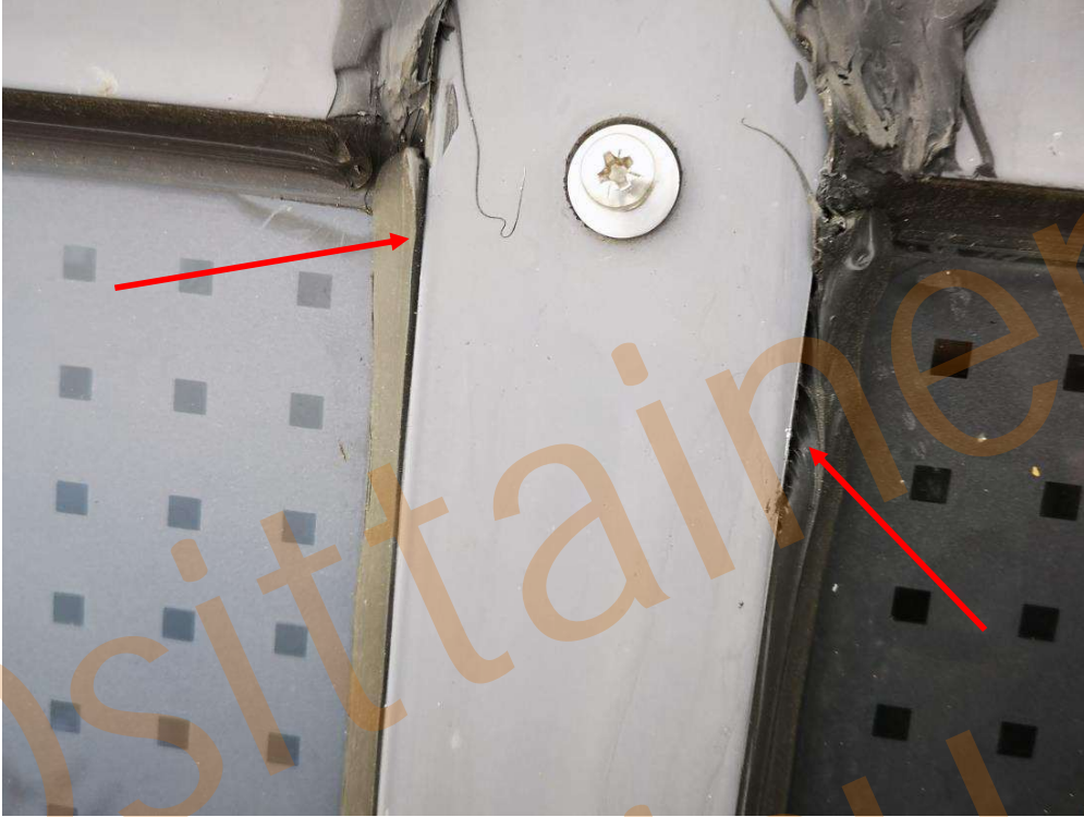
Kuva 178. Lasikaton tiivistyksen vaurioita.
