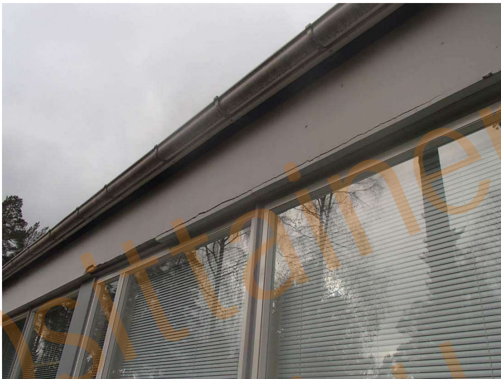
Kuva 40. Ikkunoiden yläosien kevytbetonimuurausten rappauksessa on paikoin voimakasta halkeilua.
