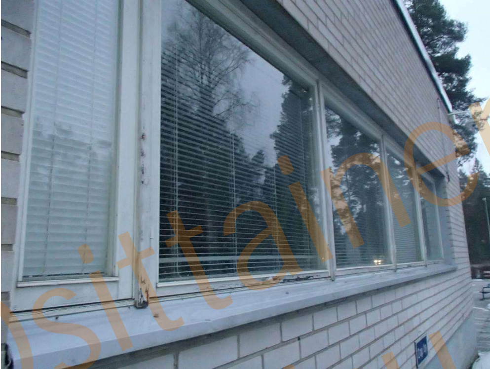
Kuva 142. Ikkunoiden alaosien puurakenteet ja maalipinnat ovat vaurioituneet.
