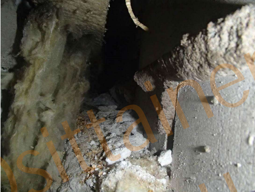
Kuva 106. Rakenneavaus RAKS 32. Kuva kastuneen ulkovaipparakenteen eristetilasta.
