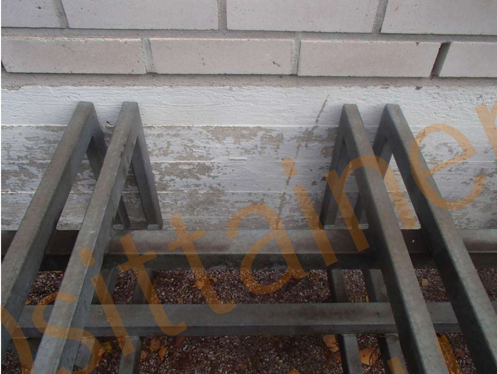
Kuva 48. Sokkelin betonipinnoilla havaittiin maalipintojen irtoilua.
