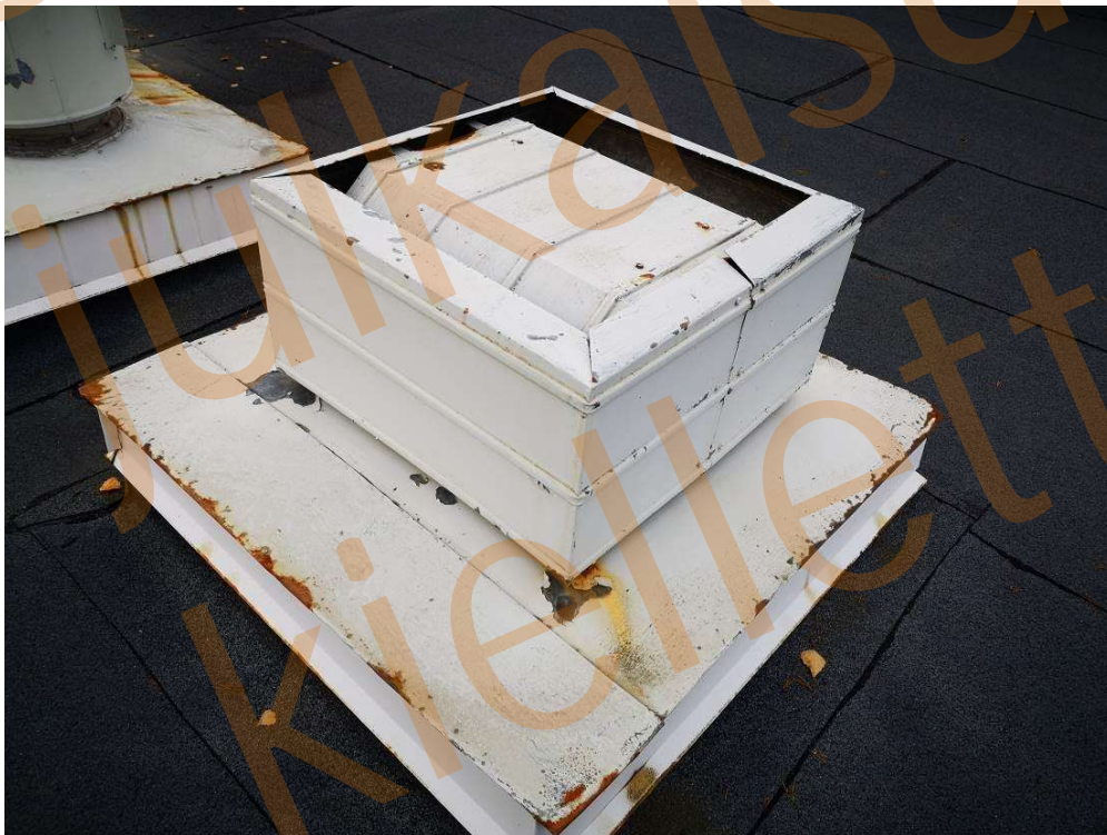
Kuva 167. Kattotarvikkeiden suojaellitysten maalipinnat ovat vaurioituneet.
