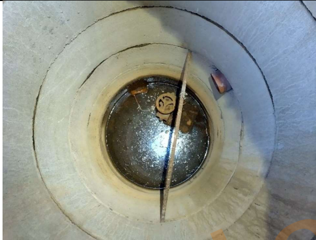
Kuva 66. SOK 5 ja padotusventtiili, ruostunut umpeen.
